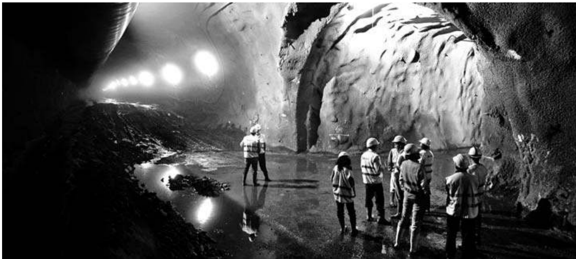
Un grupo de técnicos examina las obras de uno de los túneles con los que contará la futura línea de alta velocidad del País Vasco. :: LUIS ÁNGEL GÓMEZ
